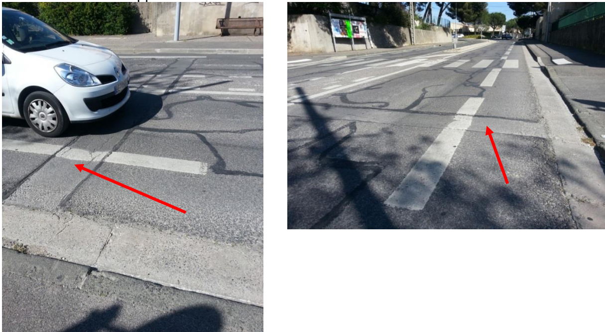
Figure 1 – Exemple d'évènement en zone urbaine : affaissement d'une tranchée
